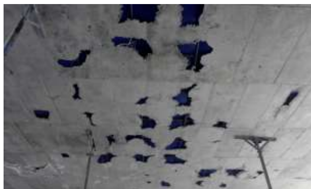
شکل ۱۶- عدم حرکت بتن در زیر قالبهای یوبوت اصلاح شده
