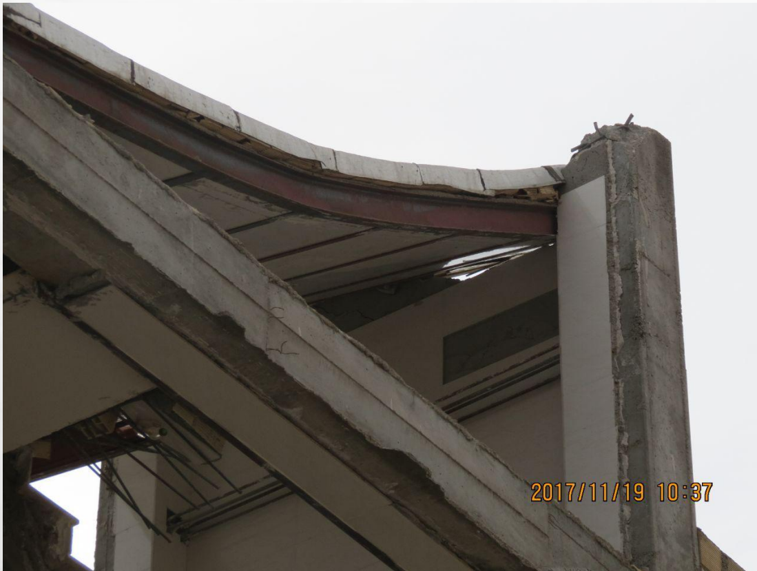
اتصال نامناسب تیر به ستون
