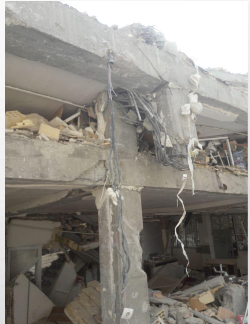
وصله نامناسب آرماتورهای طولی ستون
