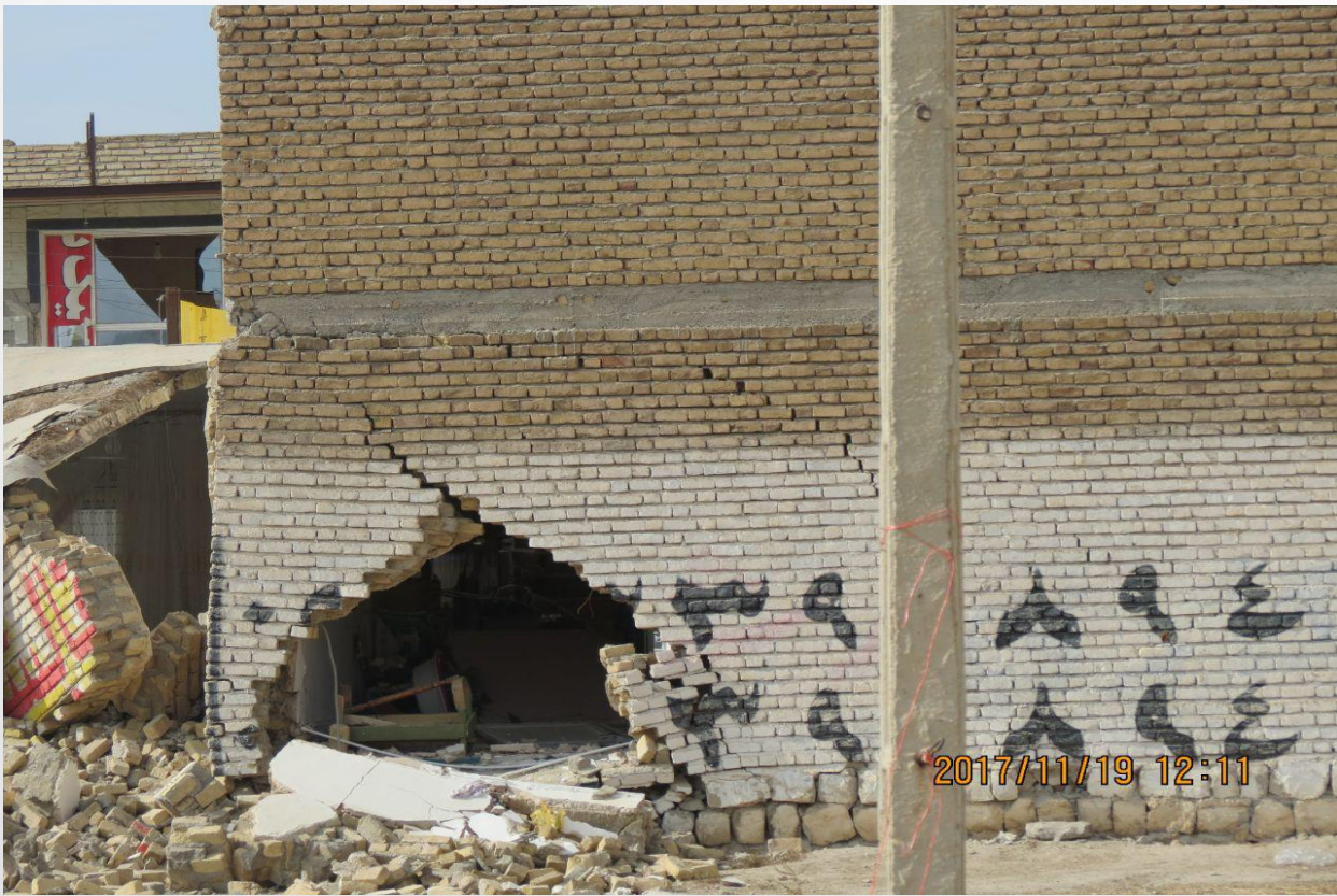
عدم وجود کلاف عمودی و شکست برشی دیوار
